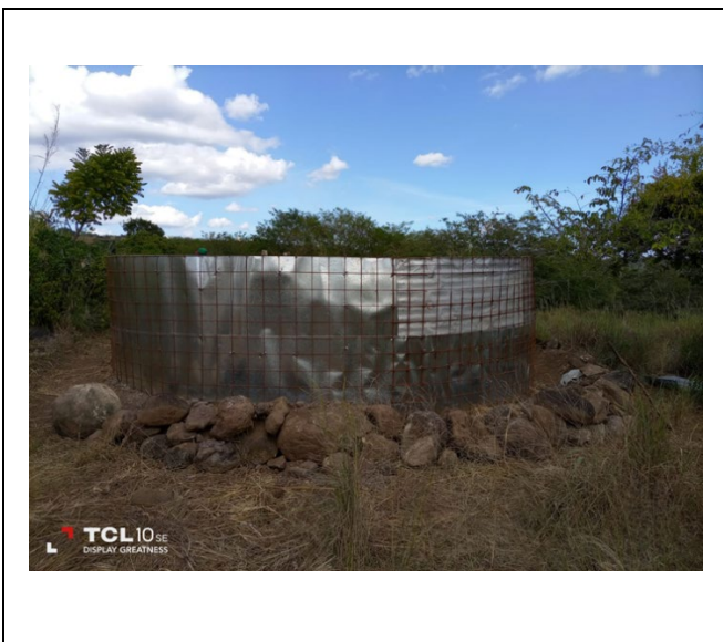
Figura 4. Tanque de almacenamiento instalado en La Oriental.
